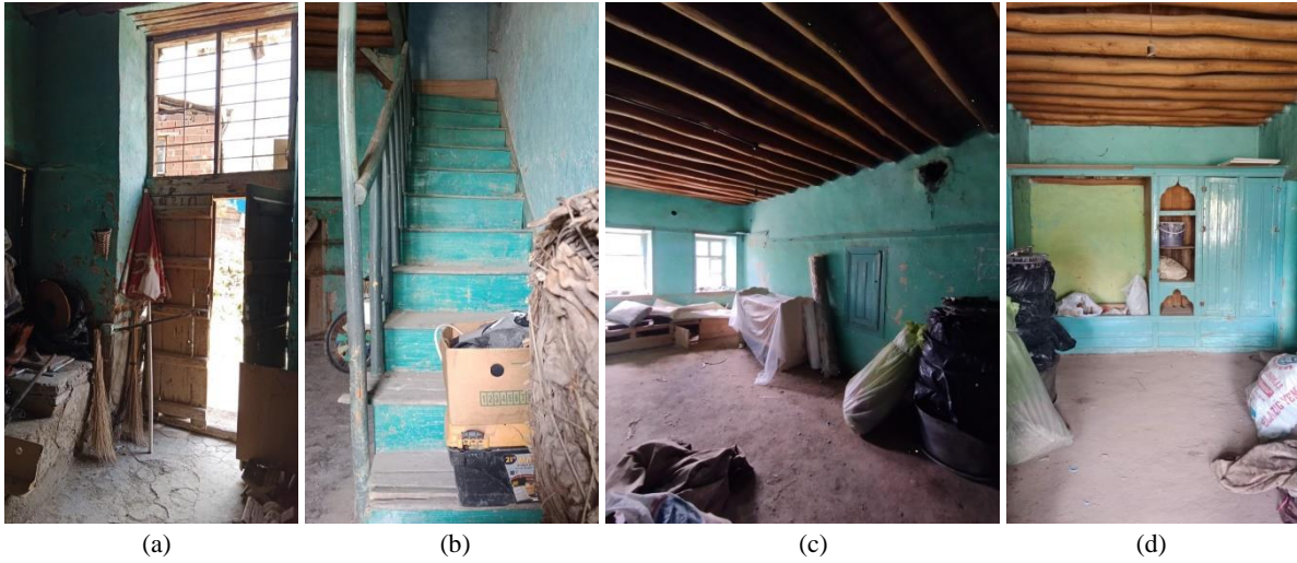
Şekil 11: Z01 mekânına açılan ana giriş kapısı (a), 1. kata ulaşan merdiven (b), Z02 mekânı (c) ve Z02 mekânındaki yüklük (d) Kaynak: Yazar arşivi, 2022.
